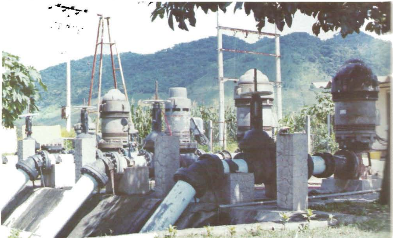
OPERACION PLANTA REBOMBEO LA CANCHA APOPA
