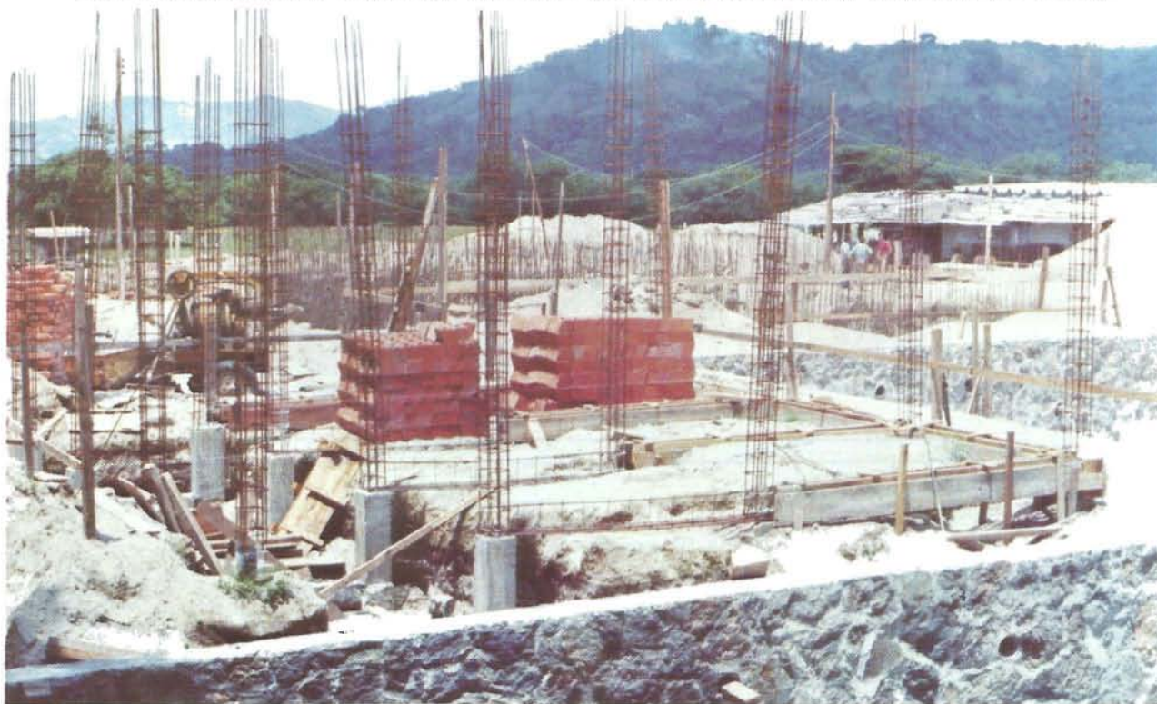
VISTA PARCIAL DE LA PLANTA DE TRATAMIENTO DEL PROYECTO RIO CUAYA. ZONA BENEFICIADA DIRECTAMENTE : BOULEVARD DEL EJERCITO Y COLONIAS ALEDAÑAS. SAN SALVADOR.
