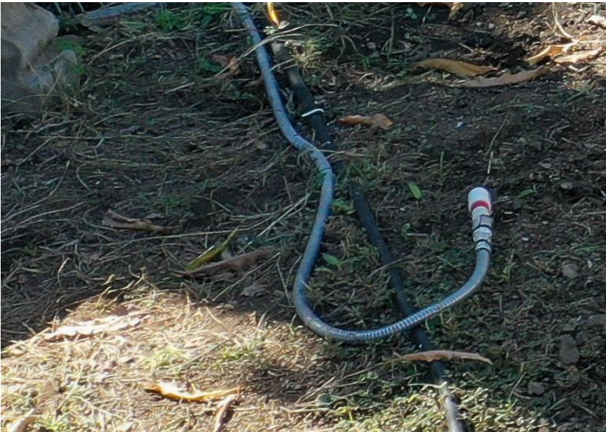
Figura 25. Instalación de sensor, parcela San Miguel.
