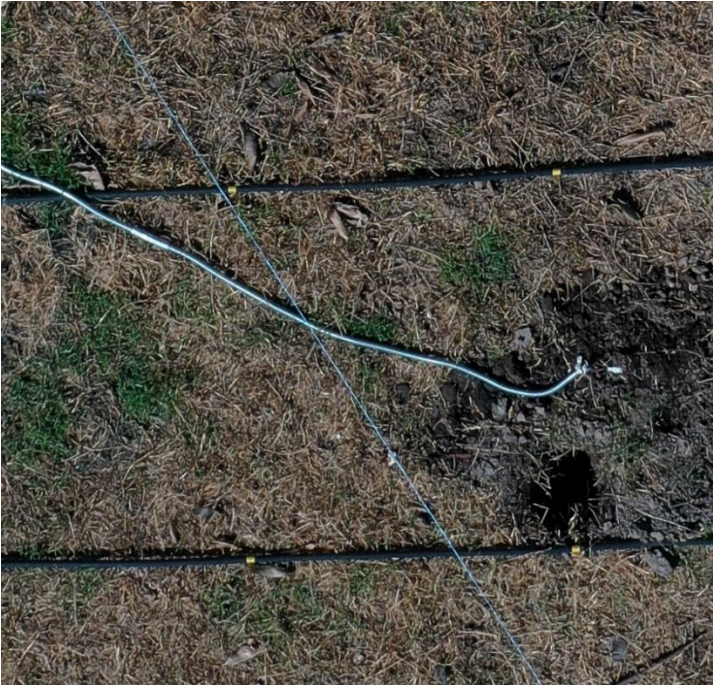
Figura 36. Instalación de sensor en parcela de Chalatenango.
