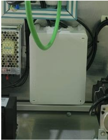
Ilustración 49: CAJA DE REGISTRO QUE ORGANIZA LOS CABLES DE MAYOR LONGITUD.
