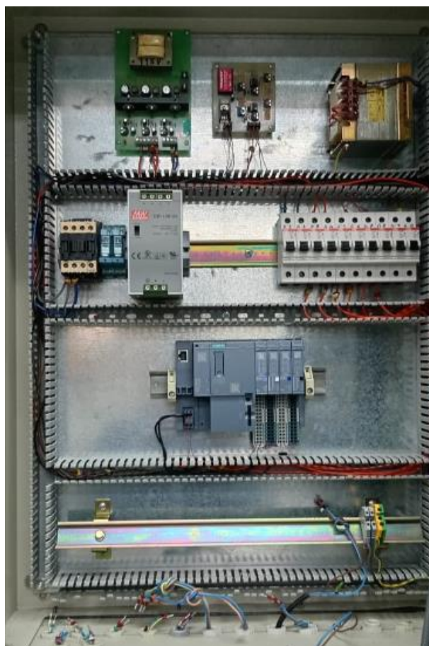
Fig. 6. Estado inicial del gabinete de control del entrenador de flujo y presión.
